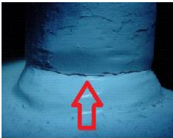
Rys.8. Widok pęknięcia na trójniku.
