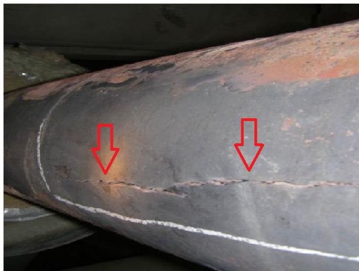
Rys.13. a) pęknięcie zlokalizowane na rurociągu,
