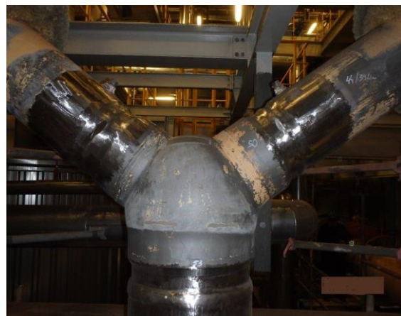
Rys.9. Trójnik rurociągu pary świeżej w trakcie procesu naprawczego.
